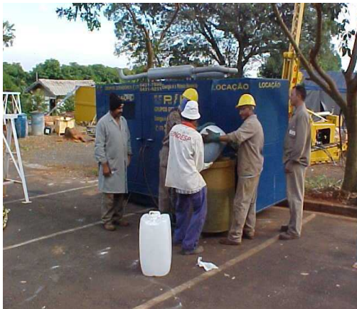
Figura 2.19. Gerador de energia.
