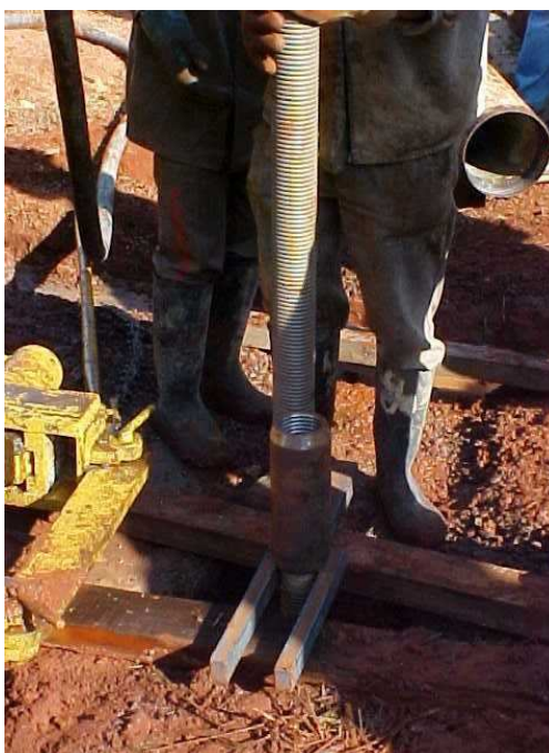
Figura 2.29. Operação de solidarização de um segmento de tirante a outro por meio da utilização de luvas metálicas.
