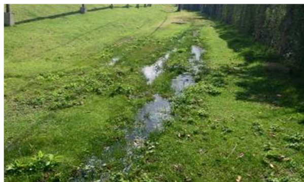
Figura 2. Surgência de percolado constatada no pé do talude do dique.
